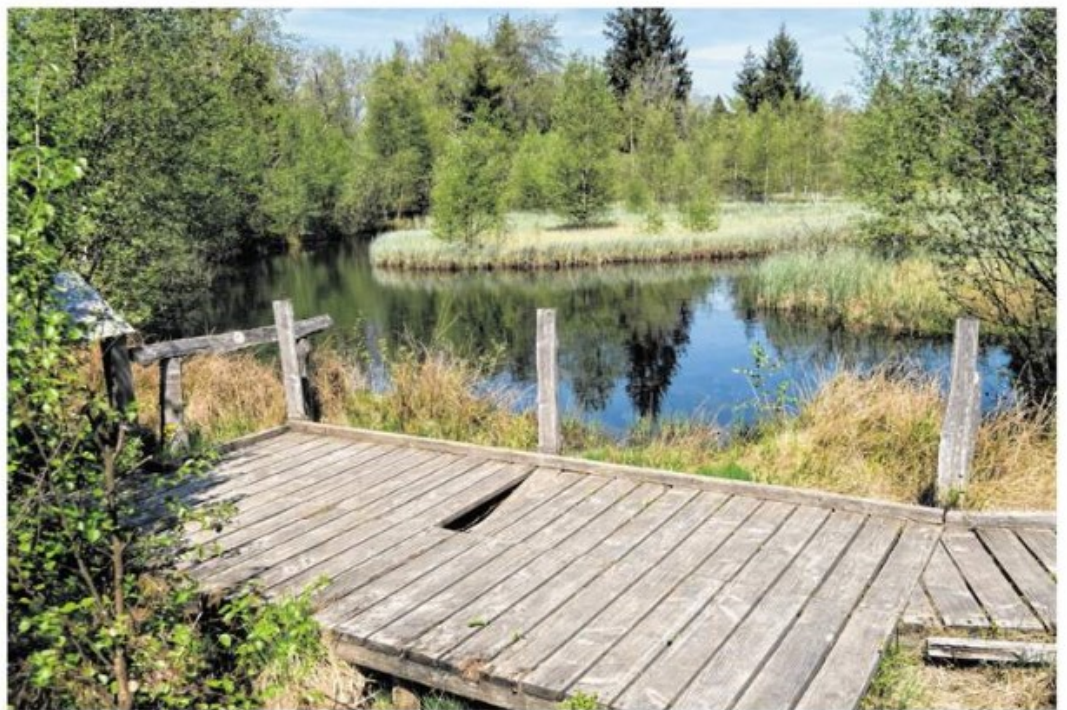
Die Steganlage am Palsen bei Mützenich ist in die Jahre gekommen und stellt inzwischen eine Gefahr dar. Jetzt soll der auch für Rollstuhlfahrer nutzbare Zugang erneuert werden. Die Städteregion favorisiert Recycling-Kunststoff.
